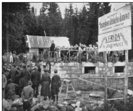
Kladení základního kamene Masarykova dětského domova 16. srpna 1925. Die Grundsteinlegung vom Masaryk-Kinderheim am 16. August 1925.
